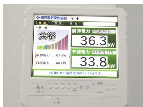
デマンド監視装置による電気使用量監視 (目標電力を60kwから55kwに下げました)
