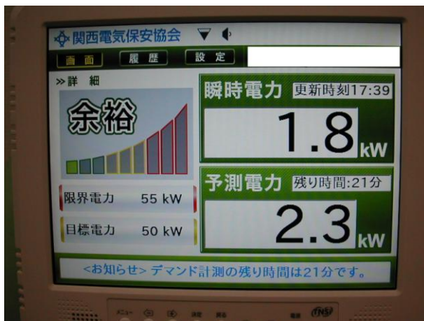
デマンド監視装置
